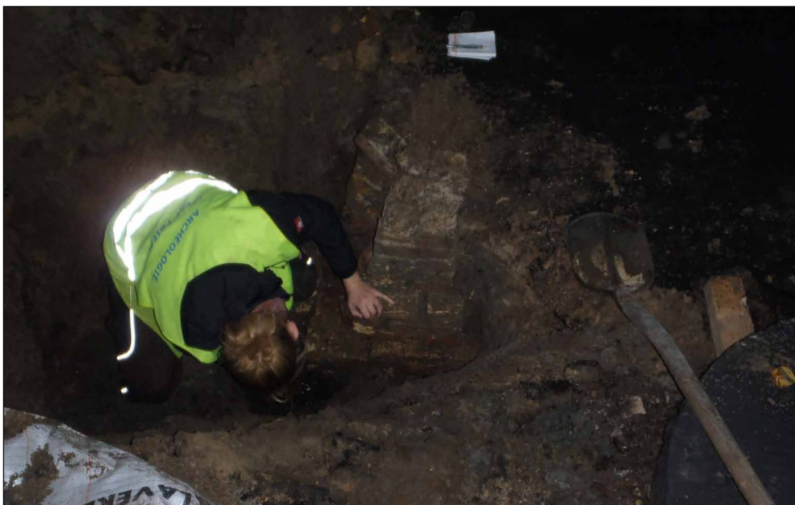
Afb. 45 Een van de poeren is uitgegraven om de diepte te kunnen bepalen.
