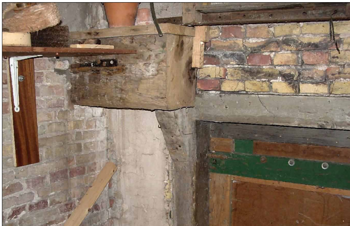
Afb. 38 Restant van de achterste balk van de onderste (verdwenen) balklaag tegen de westgevel. Monster 1 is uit dit restant gezaagd. Foto genomen voorafgaand aan de restauratie door G. Vermeer.
