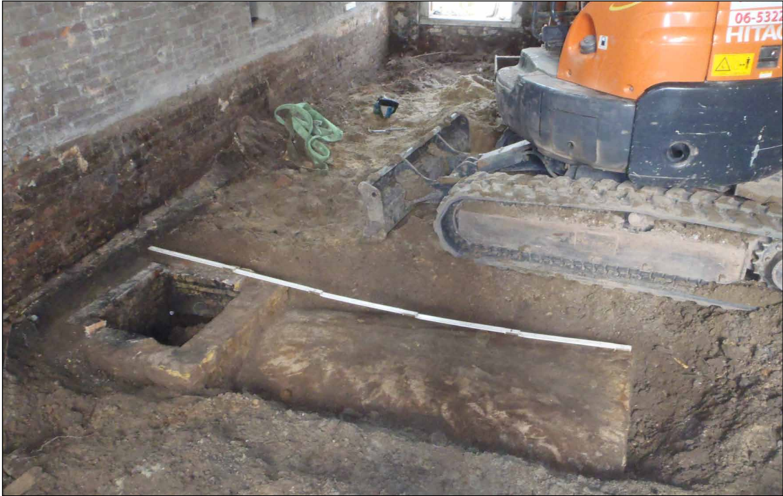
Afb. 46 De waterkelder tegen de westgevel van het pakhuis, gezien richting het noorden.
